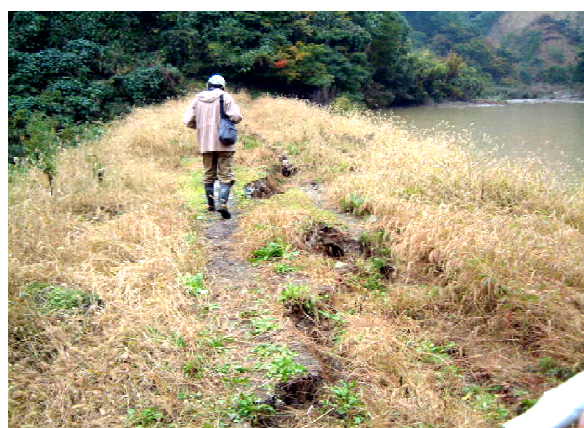
写真2 クラックが発生した堤体
