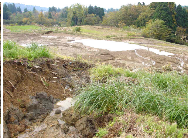
上流の池の破堤による洪水が下段の池を襲った／04. 11. 03／川口町相川
