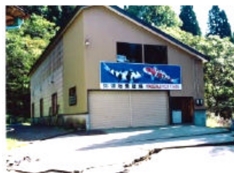
建屋の地盤が被害を受けた
