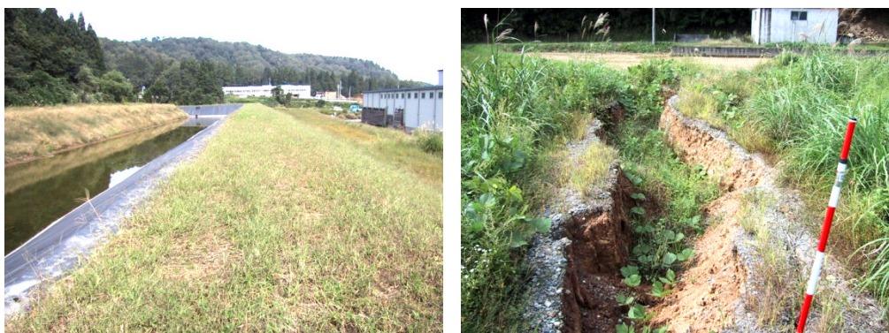
写真 被災状況が大きく異なった隣接する新旧のため池堤体（小千谷市）
