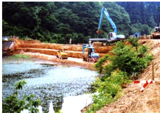
写真2 亀裂部のベンチカット(旧栃尾市)
