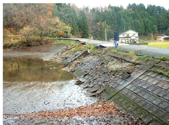
写真4 滑り破壊が発生した堤体
