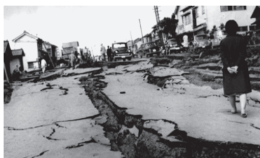
地震波による地割れした道路
