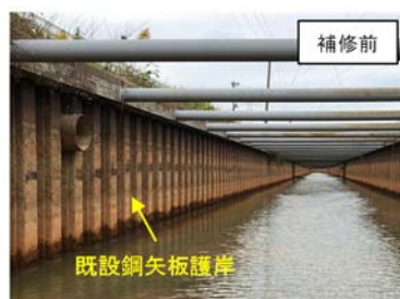
（腐食が進行する既設鋼矢板護岸）
